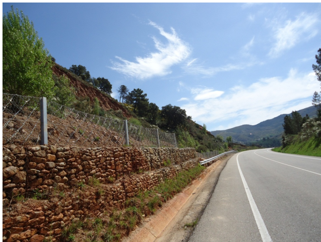
Fotografía Muro de gaviones coronado por una barrera dinámica. Inmediaciones de A Veiga
