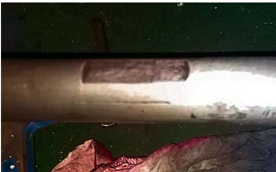
Figura 14. Daños en octubre de 2017.
