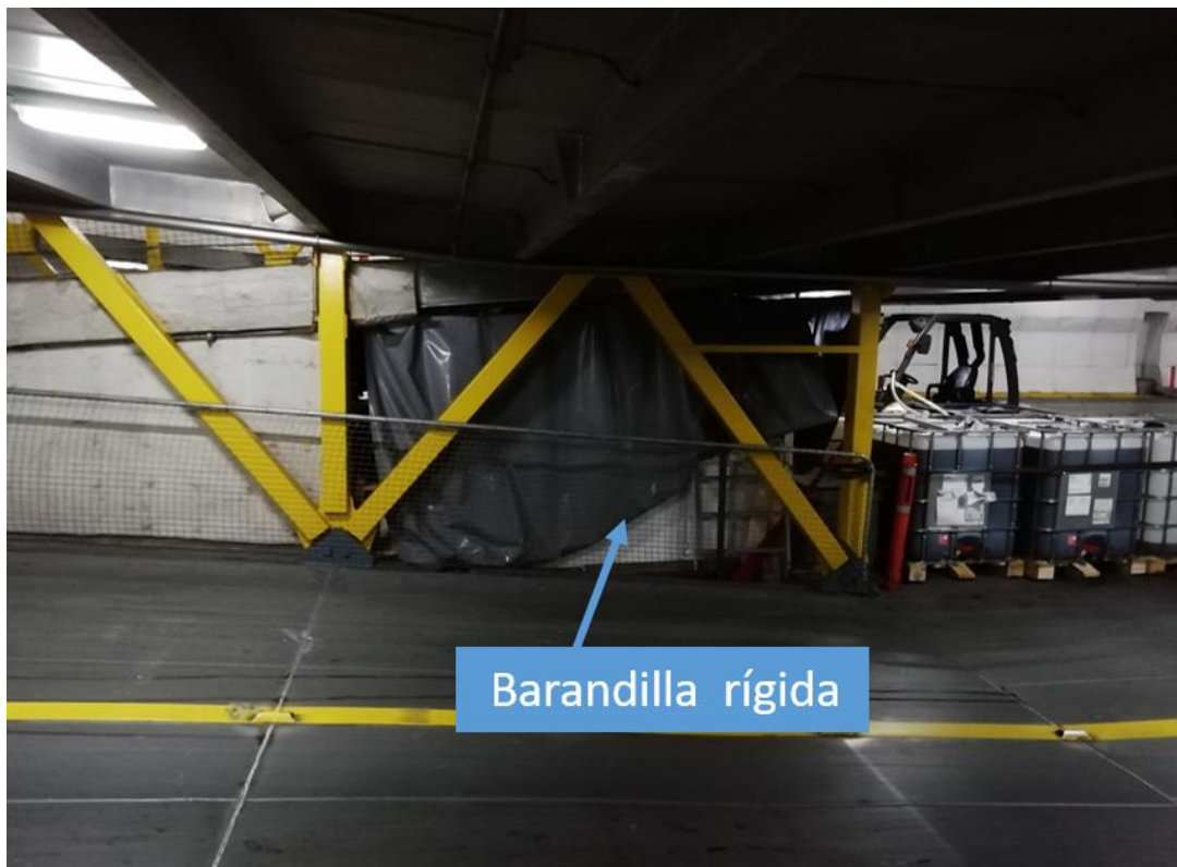
Figura 6. Tramo de rampa de vehículos equipada con barandillas rígidas a bordo del VOLCAN DE TENO .
