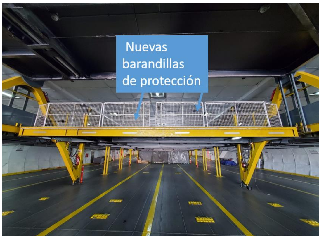
Figura 10. Cubierta elevable de vehículos equipada con las nuevas barandillas en el VOLCAN DE TENO.
