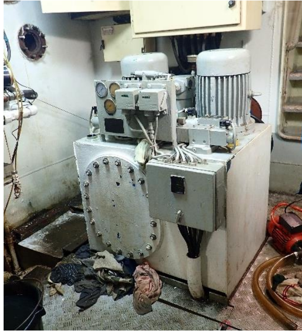
Figura 15. Unidad de potencia hidráulica y paños para recoger el aceite derramado
