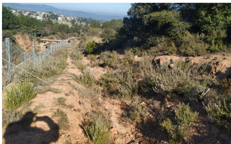
Cuneta de coronación de la vertiente anterior del talud izquierdo de la trinchera (fotografía posterior al día del accidente). (Fuente: Adif)
