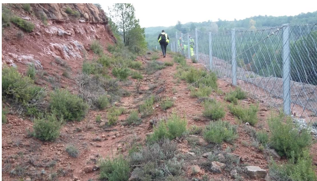
Cuneta de coronación del lado izquierdo de la trinchera en su vertiente anterior (lado Vacarisses-Torreblanca)
