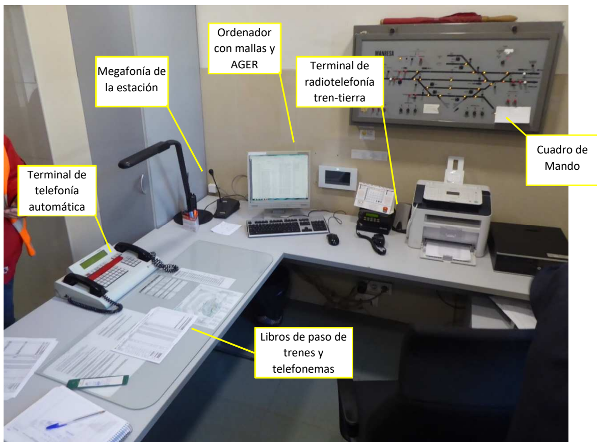
Figura 40: Puesto de trabajo del Responsable de Circulación de la estación de Manresa
