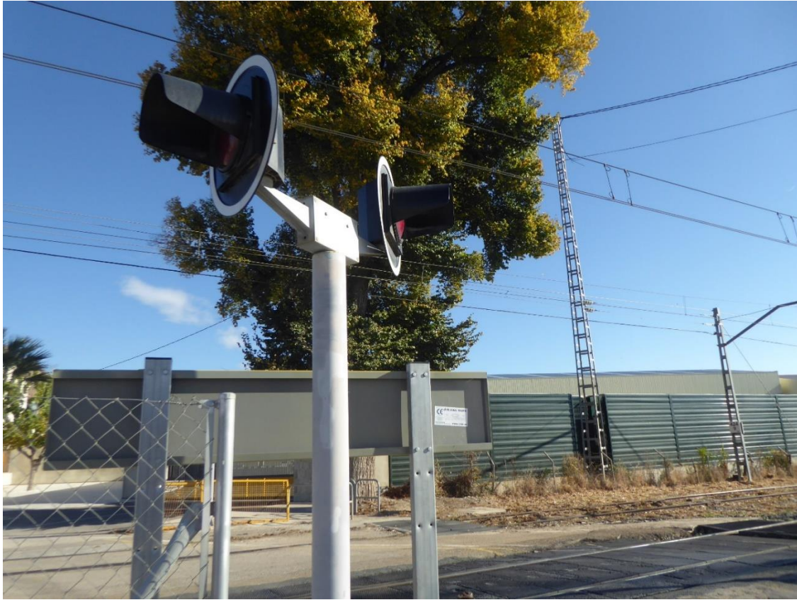
Figura 10: Señal luminosa en la esquina de las dos calles: el foco de la izquierda se orienta hacia la calle Rafael Altamira, y el de la derecha a la vía principal, Camí de Castella.
