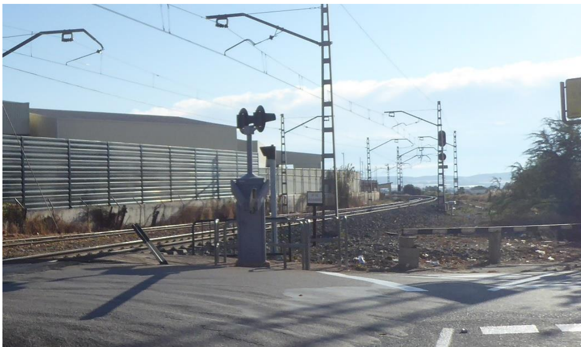
Figura 20: Vista de la semibarrera bajada, desde la calle Rafael Altamira (ampliación).
