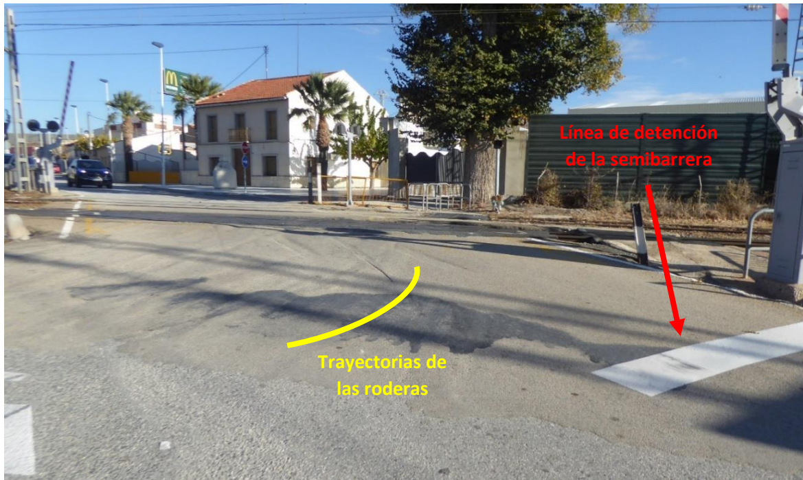
Figura 18: Roderas en el pavimento, indicando la trayectoria habitual de los vehículos entre la calle Rafael Altamira y Camí de Castella (vista desde Camí de Castella).
