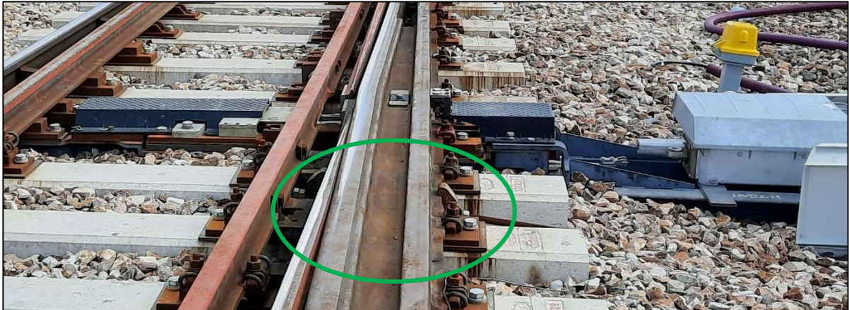
Figura 20: Vista de la brida tipo C instalada en el desvío D2.
