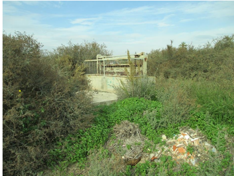
FOTO 20. PK. 1+400. Instalaciones asociadas al canal de Riegos de Levante
