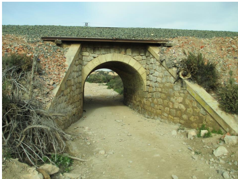
FOTO 16. PK. 0+940. ODT a sustituir
