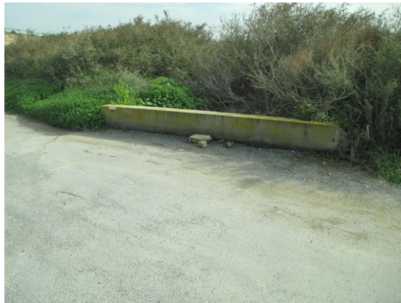
FOTO 23. PK. 1+400 (MI). Cruce del canal de Riegos de Levante bajo el camino de servicio
