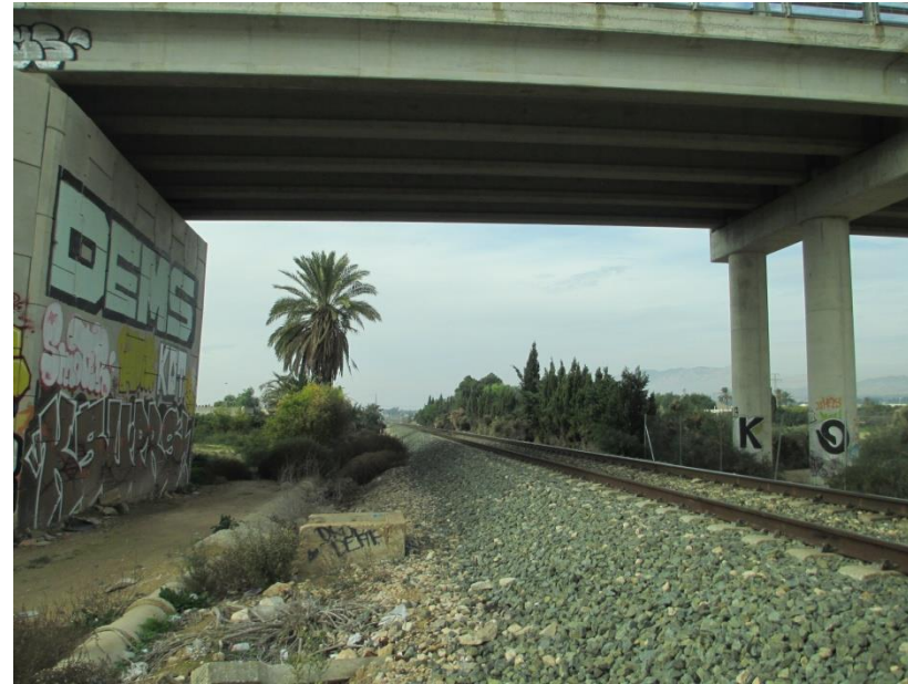
FOTO 8. PK. 0+380. PS para camino previsto para doble vía de ancho UIC. Se observa giro del estribo de suelo reforzado
