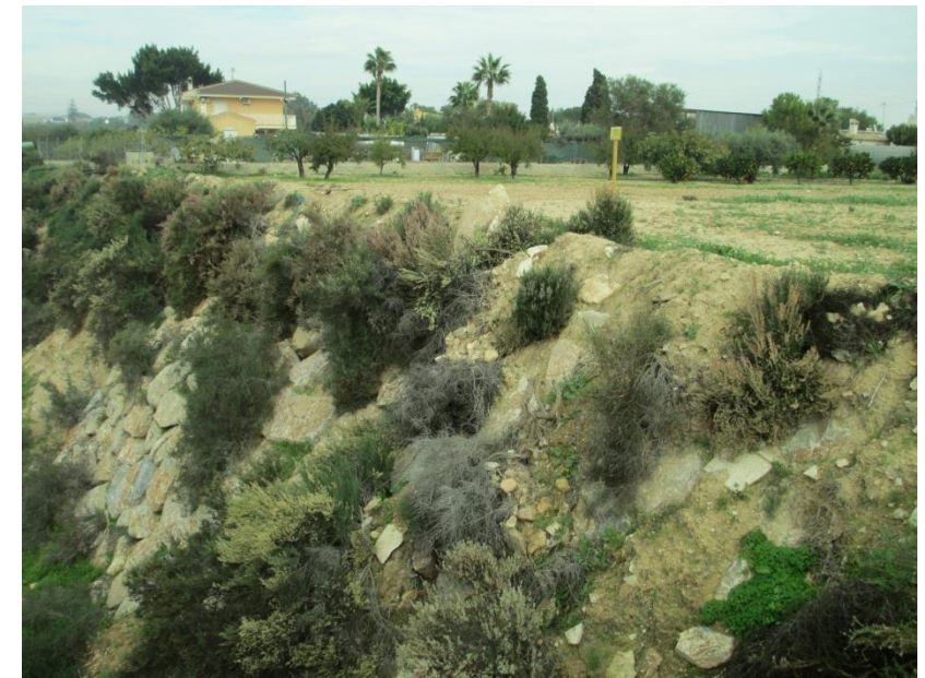
FOTO 36. PK. 2+300. Red de gas natural paralela al canal de Riegos de Levante. Protección con escollera de los taludes del barranco de Barbasena
