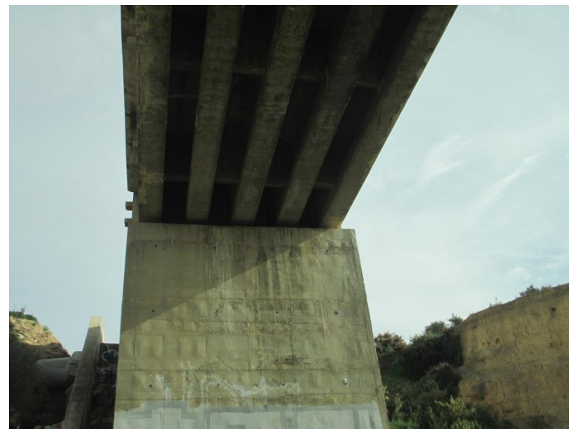
FOTO 5. PK. 0+050. Tablero de vigas de la estructura sobre el barranco de Las Monjas.
