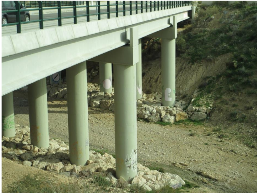
FOTO 7. PK. 0+050. Nueva estructura sobre barranco de Las Monjas, situada a 200 m aguas arriba de la estructura ferroviaria existente
