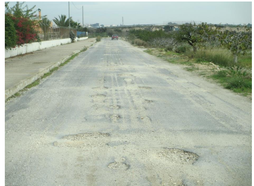
FOTO 24. PK. 1+400. Vista del camino de servicio y del canal de Riegos de Levante, sentido centro urbano de Elche
