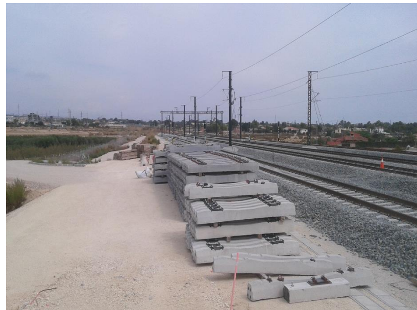
FOTO 53. Vías principales y de apartado de la estación Elche Alta Velocidad
