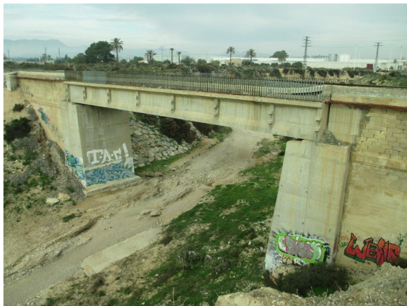
FOTO 4. PK. 0+050. Estructura sobre el barranco de Las Monjas. Vista de la zona de aguas abajo. Base de los estribos descubiertas
