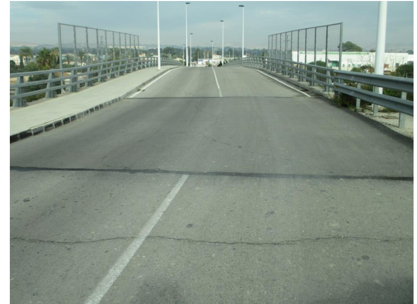
FOTO 9. PK. 0+380. Reparaciones y grietas del pavimento en coincidencia con el estribo girado
