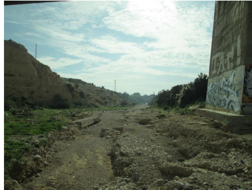
FOTO 2. PK. 0+050. Estructura sobre el barranco de Las Monjas. Vista del cauce aguas abajo. Base de los estribos descubiertas
