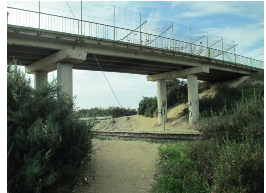
FOTO 15. PK. 1+370. PS de camino. Vista sentido Crevillente. Antes de esta estructura la nueva traza se separa de la existente
