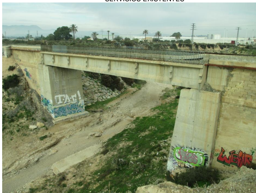
FIGURA 29. ESTRUCTURA SOBRE EL BARRANCO DE LAS MONJAS. ZONA DE AGUAS ABAJO. BASE DE LOS ESTRIBOS DESCUBIERTAS
