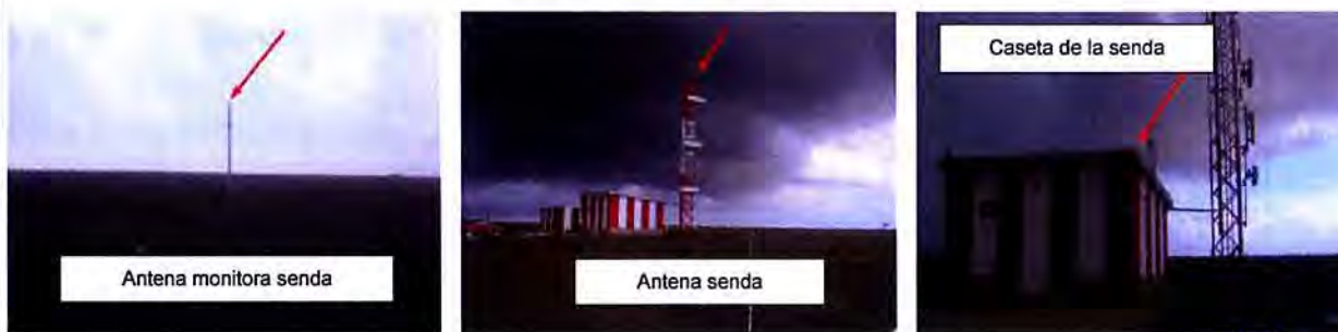
Ilustración 5.2.- Antena, antena monitora y caseta de reguladores de la senda de planeo, situados en el interior de la franja de pista
