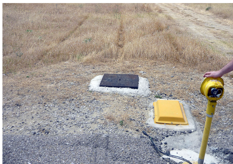
Figura 2. Arqueta metálica y baliza de iluminación
