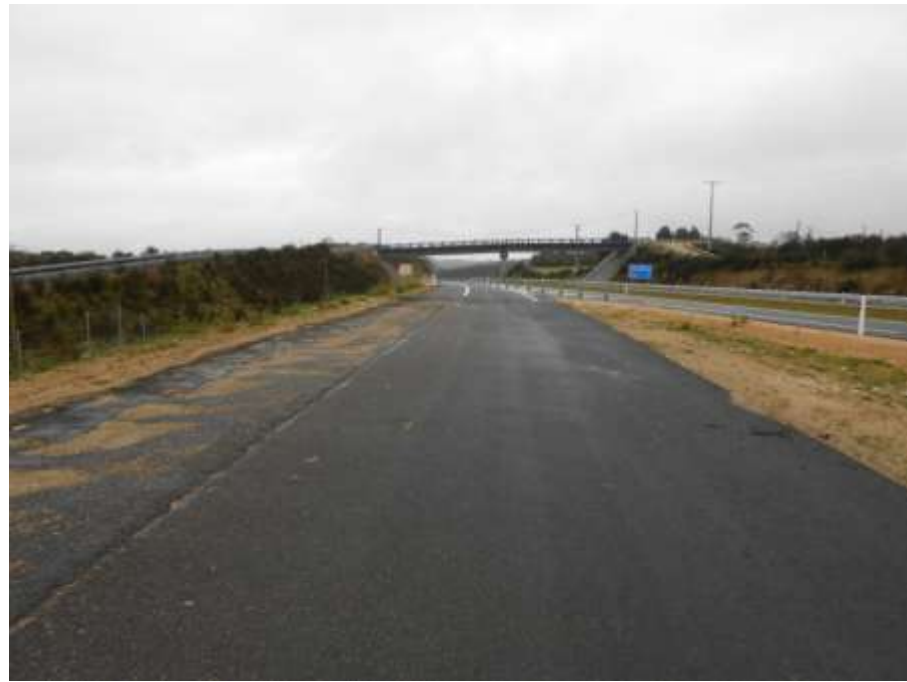
Foto 47: Margen derecha. Carril de acceso a la semiárea. Falta rodadura.
