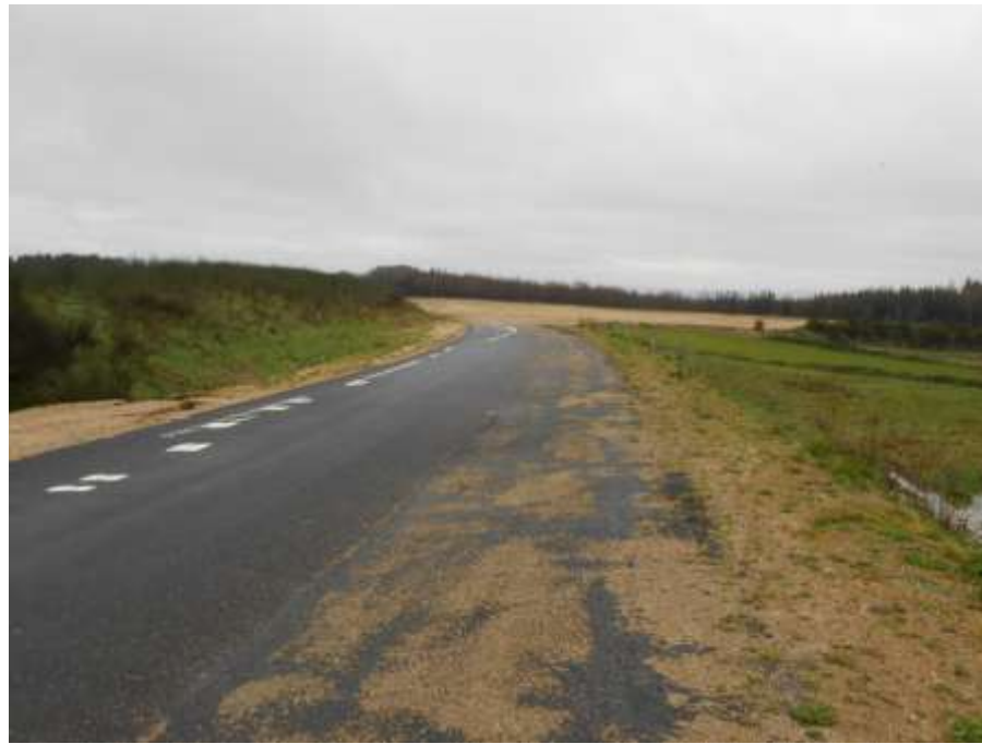
Foto 49: Margen derecha. Carril de acceso a la semiárea. Falta rodadura.
