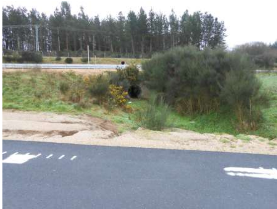
Foto 51: Margen derecha. Carril de acceso a la semiárea. Falta rodadura. ODT
