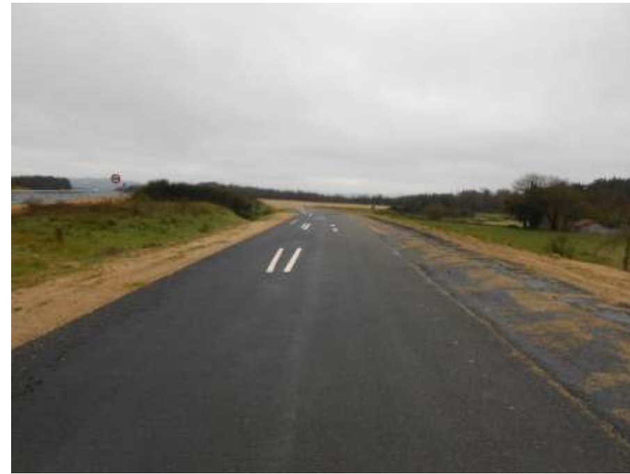
Foto 48: Margen derecha. Carril de acceso a la semiárea. Falta rodadura.
