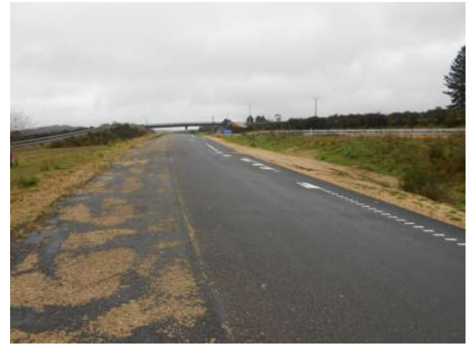
Foto 50 Margen derecha. Carril de acceso a la semiárea. Falta rodadura.
