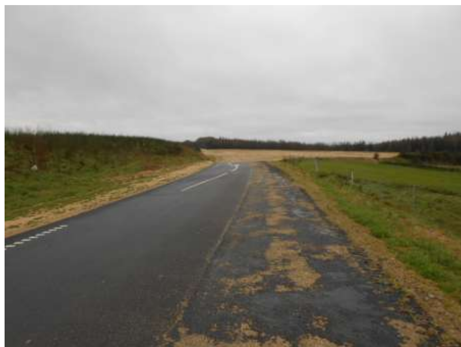
Foto 53: Margen derecha. Carril de acceso a la semiárea. Falta rodadura.
