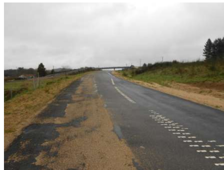
Foto 54: Margen derecha. Carril de acceso a la semiárea. Falta rodadura.
