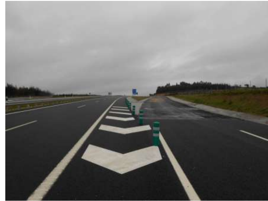
Foto 6: Margen izquierda. Fin del carril de deceleración. Se observa la falta de rodadura.
