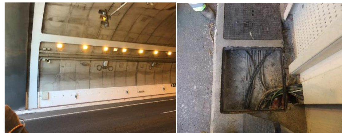
Bandejas situadas en los hastiales (izquierda)- Cables bajo acera en Túnel Sur (derecha) Canalizaciones para cables en los Túneles de Aguadulce
