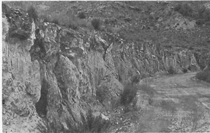
Foto 83.—Margas de la Rambla de la Yedra, grupo 30g, obsérvese la alteración de los taludes en las zonas no recubiertas de coluviales. (Cuadrante 870--4).
