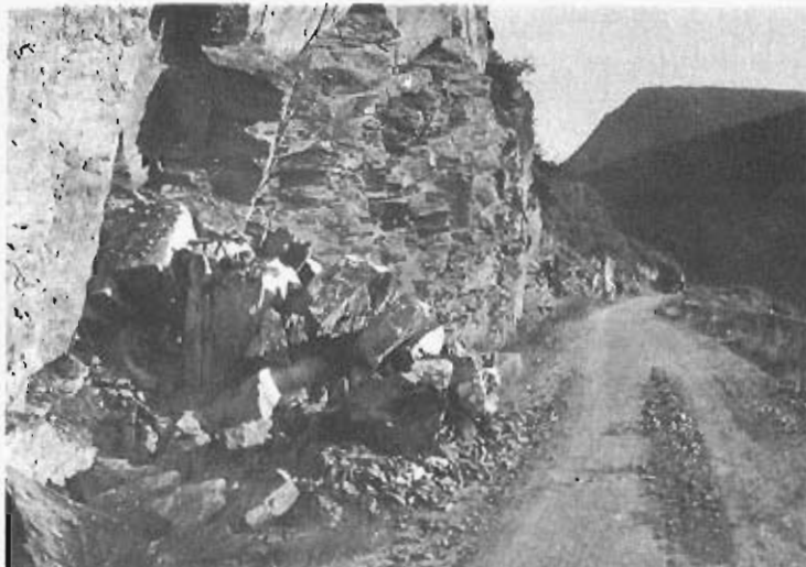
Foto 3-23 — Desprendimientos en la carretera de Congosto a Santa Marina de Sill en los materiales Ordovícicos.
