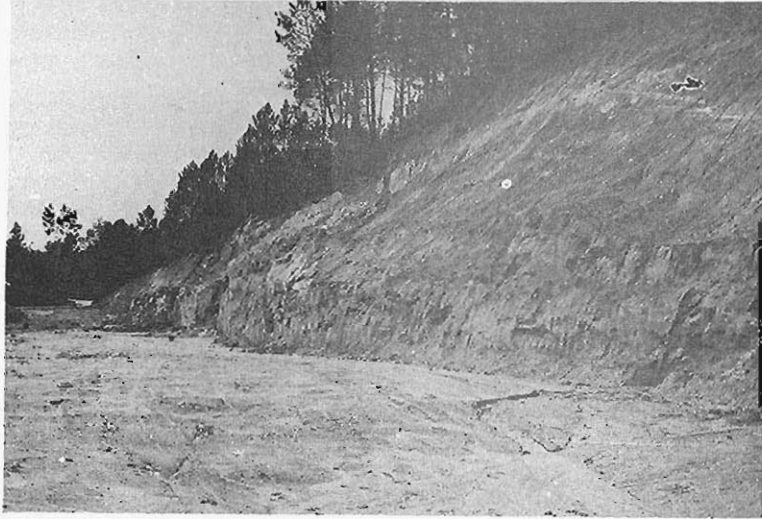
Foto 3. Taludes en granitos alterados en la C.N. 525 Santiago-Orense p.k. 560.
