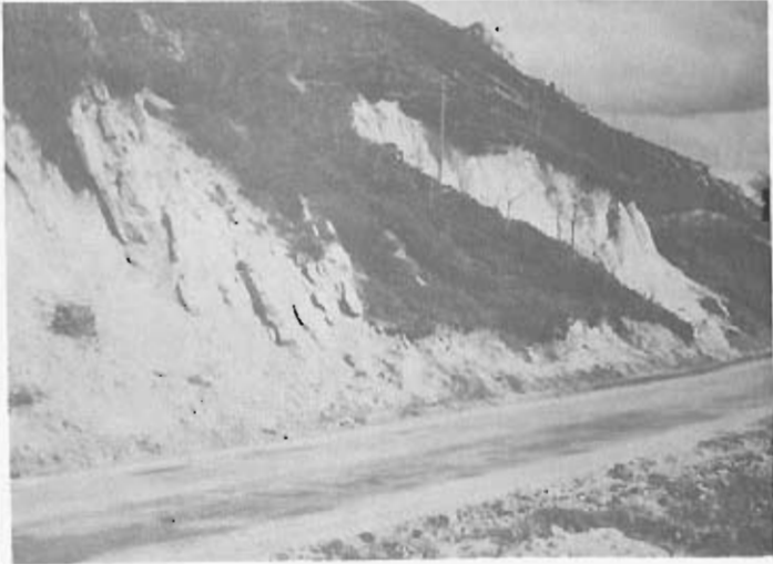
Foto 43.— Taludes con desprendimientos y acarcamientos en los materiales del grupo 231a' al excavarse con inclinación superior a la adecuada. (Cuadrante 134-1).
