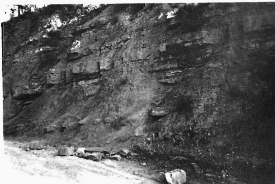
Foto 97.— Talud artificial tallado a unos 65° en los materiales del grupo 312m1 con degradación y caída de bloques, en el camino paralelo al río Rajadell. (Cuadrante 362—4).
