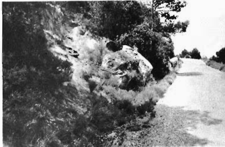
Foto 109.— Detalle de bloque desprendido en las areniscas terciarias, carretera C-1412 Tramo Gualter—La Serra, (Cuadrante 329-4).
