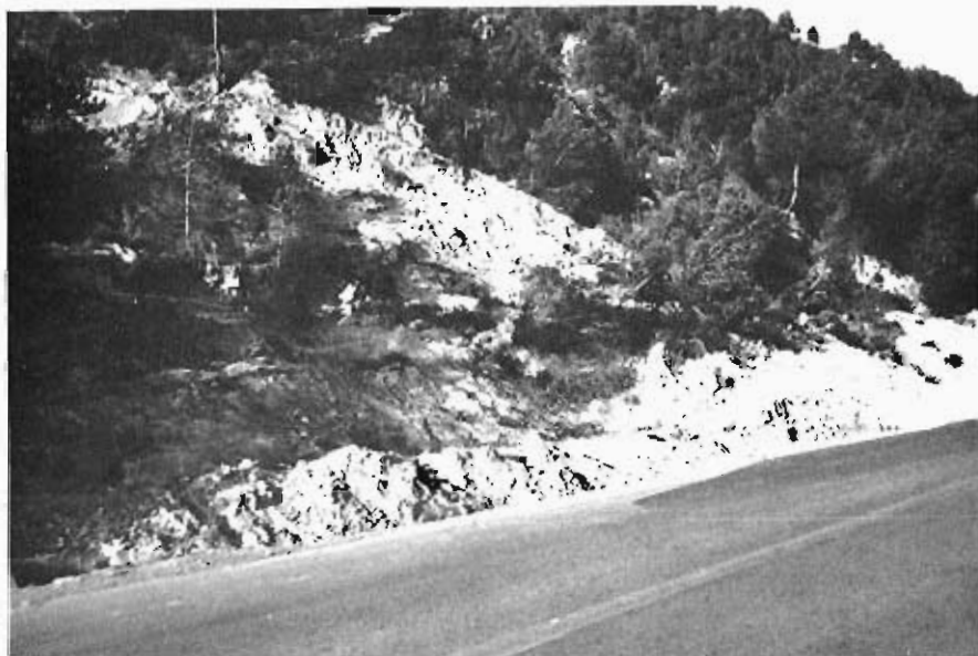
Foto 94.— Pequeño deslizamiento producido en la ladera junto al P.K. 16 de la Carretera Manresa—Calaf, grupo 313a (Cuadrante 362–1).
