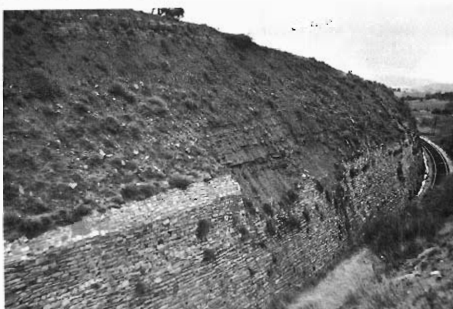
Foto 75.— Muro de contención roto por el empuje de las arcillas del grupo 313g3 en las inmediaciones de Segur (Cuadrante 362—3).
