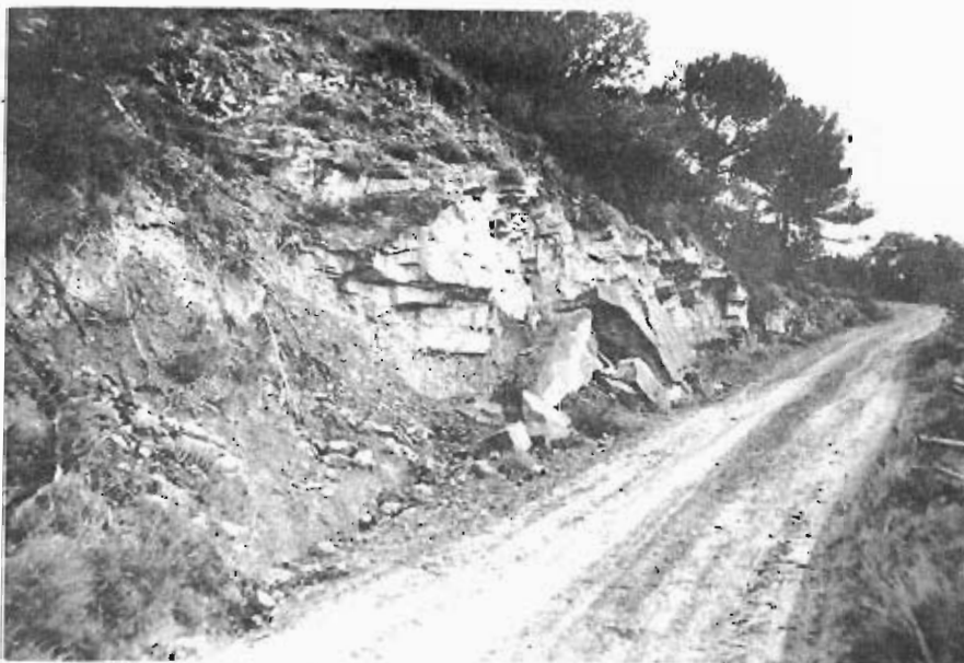
Foto 88.— Rotura y caída de bloques de arenisca por socavación de las margas infrayacentes, grupo 313e, camino de Saló a Matamargós (Cuadrante 330—3).
