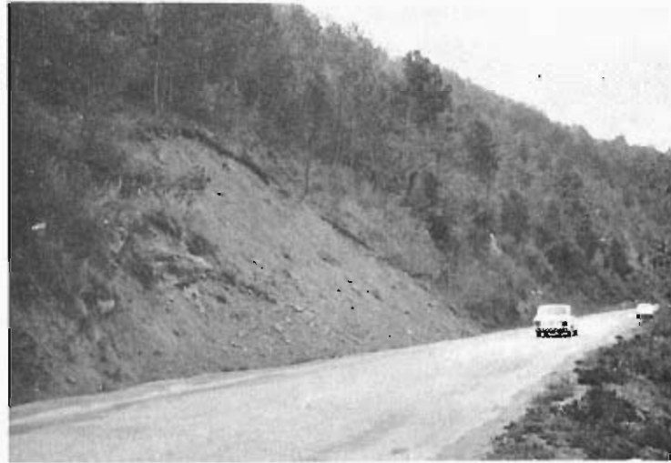
Foto 111.— Deslizamiento coincidente con un área fallada, materiales del terciario continental en la carretera C-1313. (Cuadrante 329-4).
