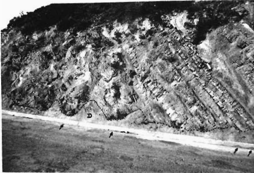
Foto 10B.— Talud artificial subvertical en el grupo 312m2, carretera B-423, obsérvese el área de derrubios D y el cagado de la cunata en los puntos marcados por las flechas (Cuadrante 362-1).
