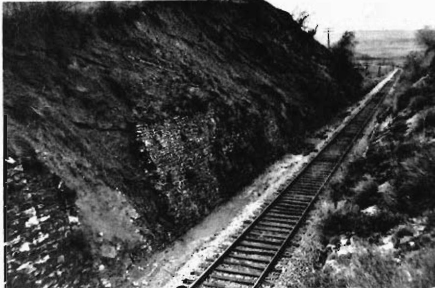
Foto 76.— Ruina parcial del muro de ferrocarril al este de San Martín de Sasgoyolas debido a los movimientos de arcillas del grupo 313d1 (1) que al fondo quedan recubiertas por las areniscas de la base del grupo 313e2 (2) (Cuadrante 362–3).
