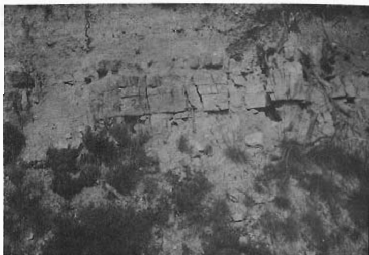
Foto 74.— Talud artificial inestable ( 75^{\circ} ) en el grupo 313h1 (Cuadrante 361-1).
