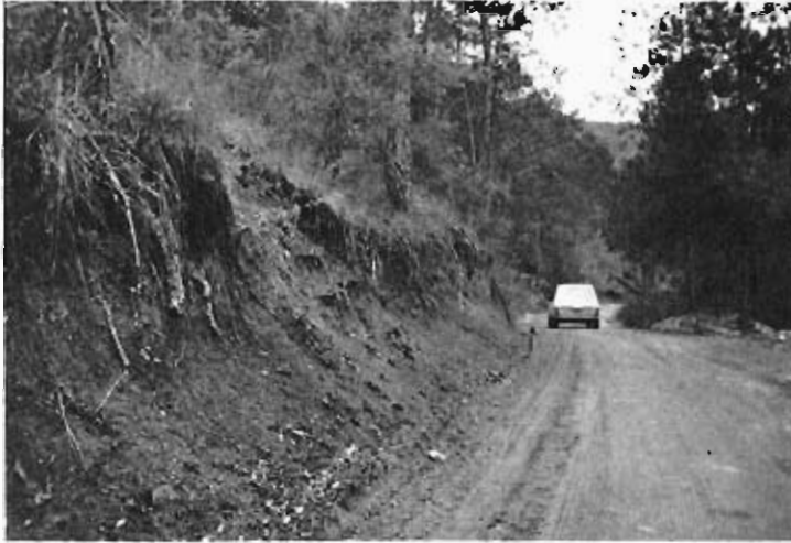
Foto 22.— Taludes artificiales en degradación sobre el grupo C8 (Cuadrante 329—4).
