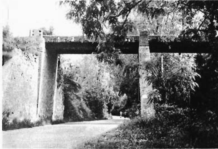
Foto 112.— Pilar inclinado por fluencia lateral de los yesos del grupo 312r2 en el cauce del torrente de Iborra carretera L.V.-3003. (Cuadrante 361-1).
