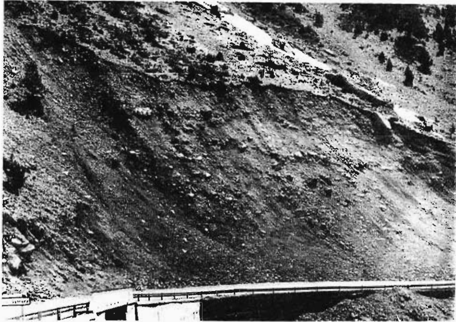
Foto 22.- Desmorte de gran altura sobre los materiales del grupo C3, afectado por graves problemas de erosionabilidad y desprendimiento. Fotografía tomada en la carretera a Francia, por Bielsa, a la altura de Bordás.
