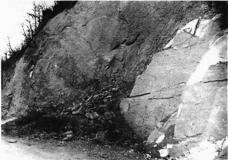
Foto 55.— Areniscas y limolitas del grupo 211. Se aprecia la semi ortogonalidad del diaclasado. Fotografía tomada del deslizamiento ocurrido en Marzo a 2 Km al oeste de Noales.
