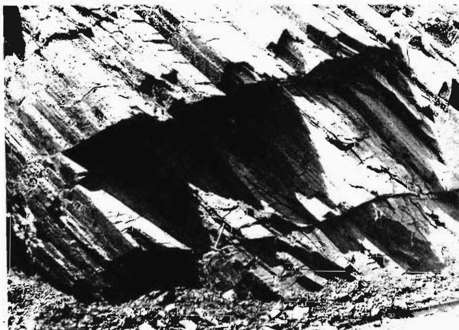
Foto 104.— Aspecto de los materiales muy metamorfizados del grupo 001b en un desmonte de la carretera de Bielsa a Francia, en las proximidades de la boca sur del túnel de Bielsa.
