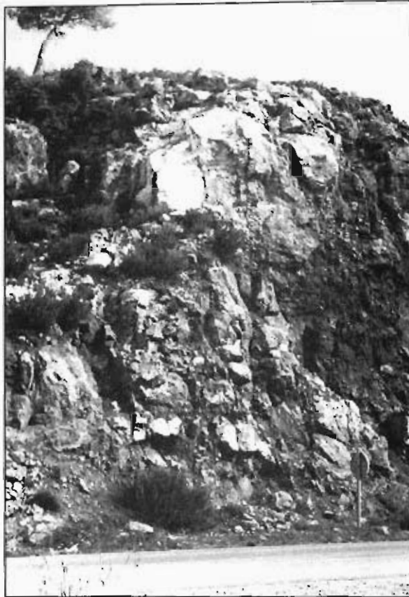
Foto 7.— Talud en las dolomías 221a. Carretera Balazote-Robledo.
