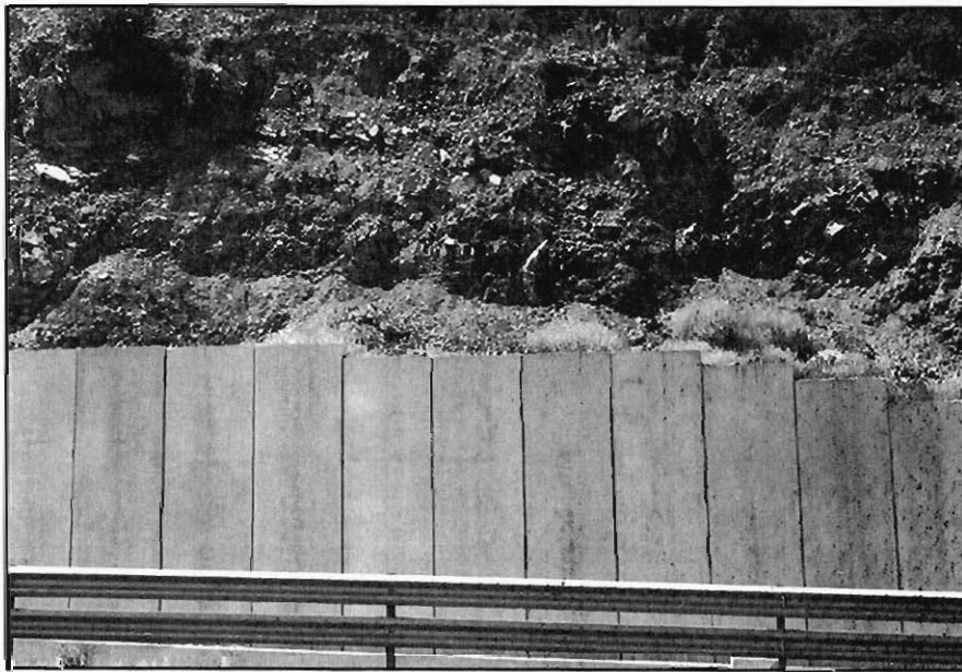
Figura 3.11.- Muro de contención, realizado en un desmonte de la carretera N-630, que sujeta un horizonte de alteración del grupo (143a). Proximidades de la Venta del Alto (Hoja 962-4).
