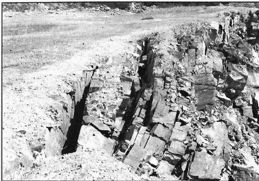
Figura 3.22.- Vuelcos de estratos en un talud de una cantera, abierta en los basaltos y espilitas del grupo 151, para la construcción de una presa en el río Crispinejo (Hoja 961-2).
