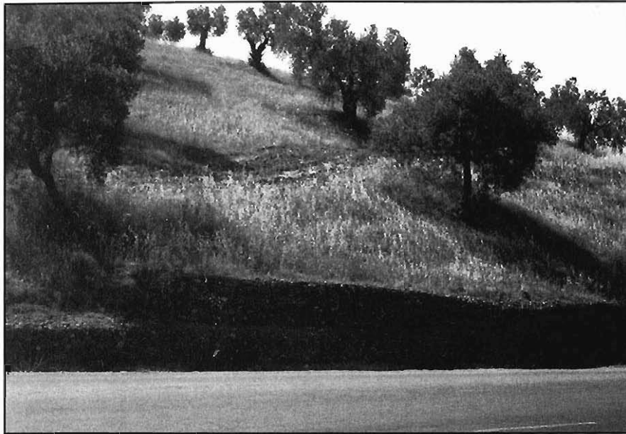
Figura 3.44.- Deslizamiento circular en las margas azules, producido en una ladera de la Cuesta de las Doblas, en las cercanías de Sanlúcar la Mayor (Hoja 983-2). Obsérvese la deformación provocada en los gaviones.
