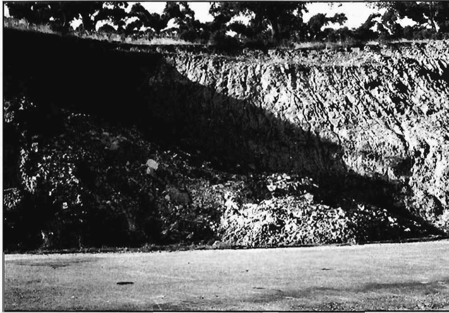
Figura 3.14.B.- Aspecto del mismo talud de la Figura 3.14.A durante la temporada invernal, y después de grandes lluvias. Comparando las dos figuras se observa la zona deslizada.
