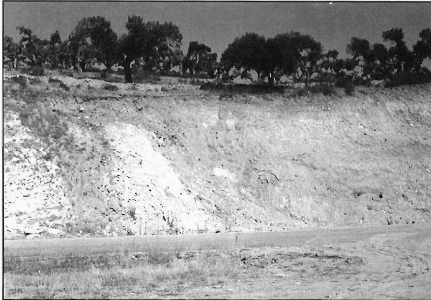
Figura 3.14.A.- Aspecto en época estival de un talud artificial de la carretera entre Aldehuela de la Bóveda y Garcirrey (Hoja 477-3), realizado en las arenas arcillosas del grupo (321), en contacto con un filón de aplita y con micacitas alteradas.
