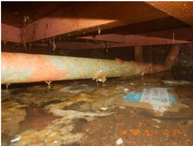
Figura 5. Tubería corroída en 2014 (1)
