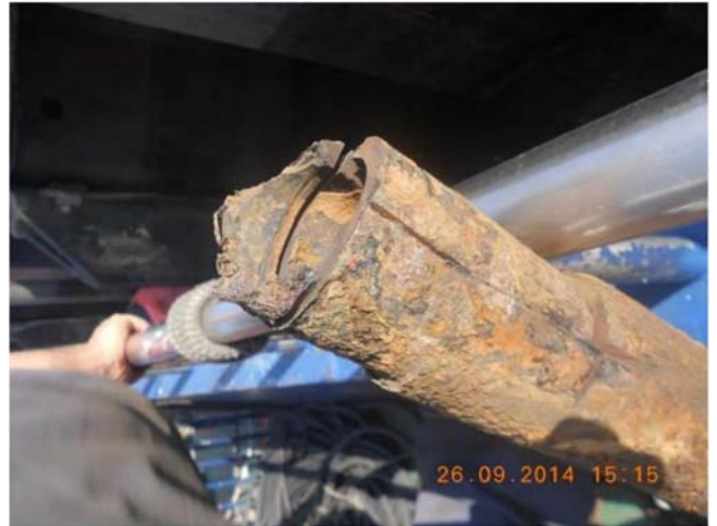
Figura 6. Tubería corroída en 2014 (2)
