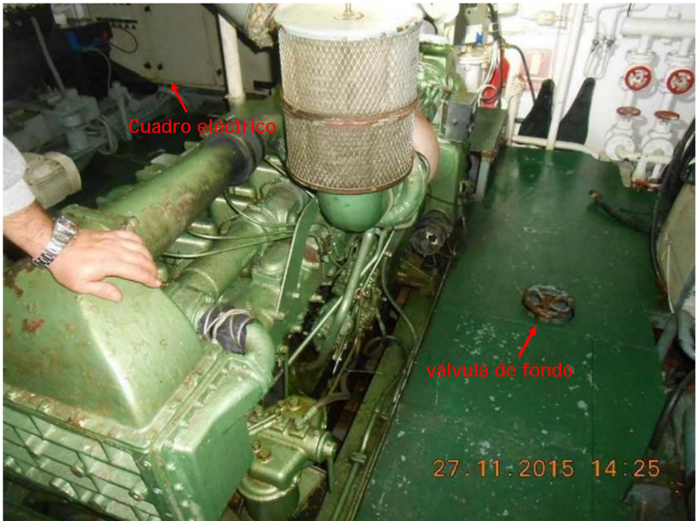
Figura 10. Cámara de máquinas banda de estribor
