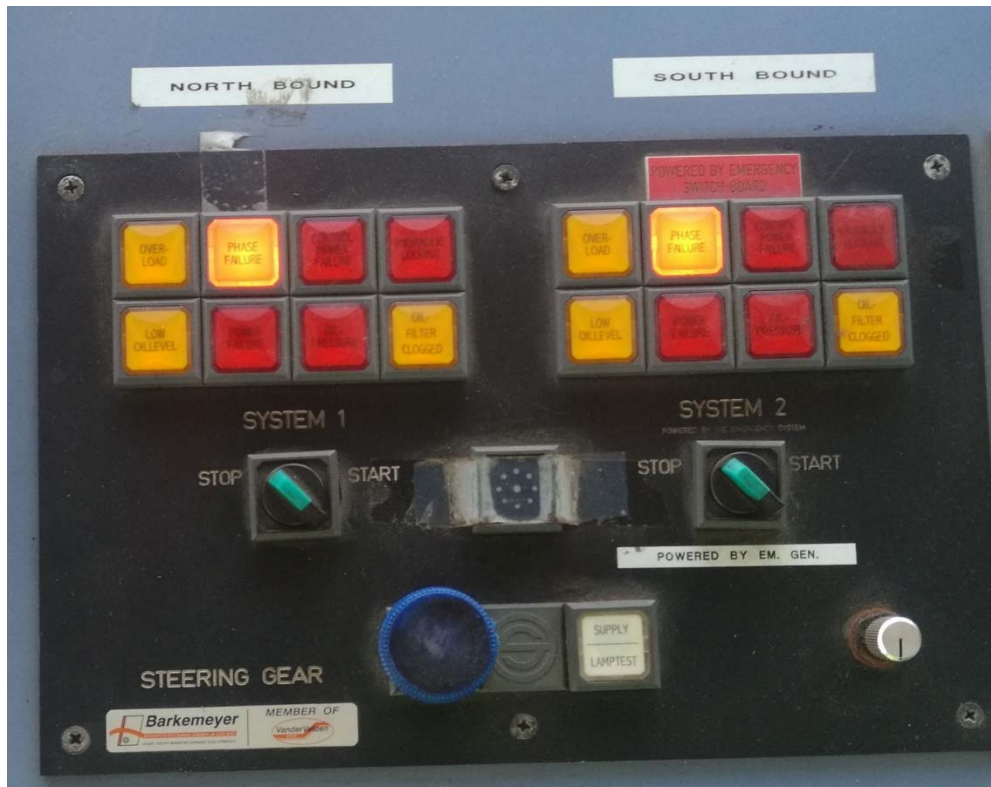
Figura 10. Cuadro de alarmas y actuadores de las bombas del aparato de gobierno
