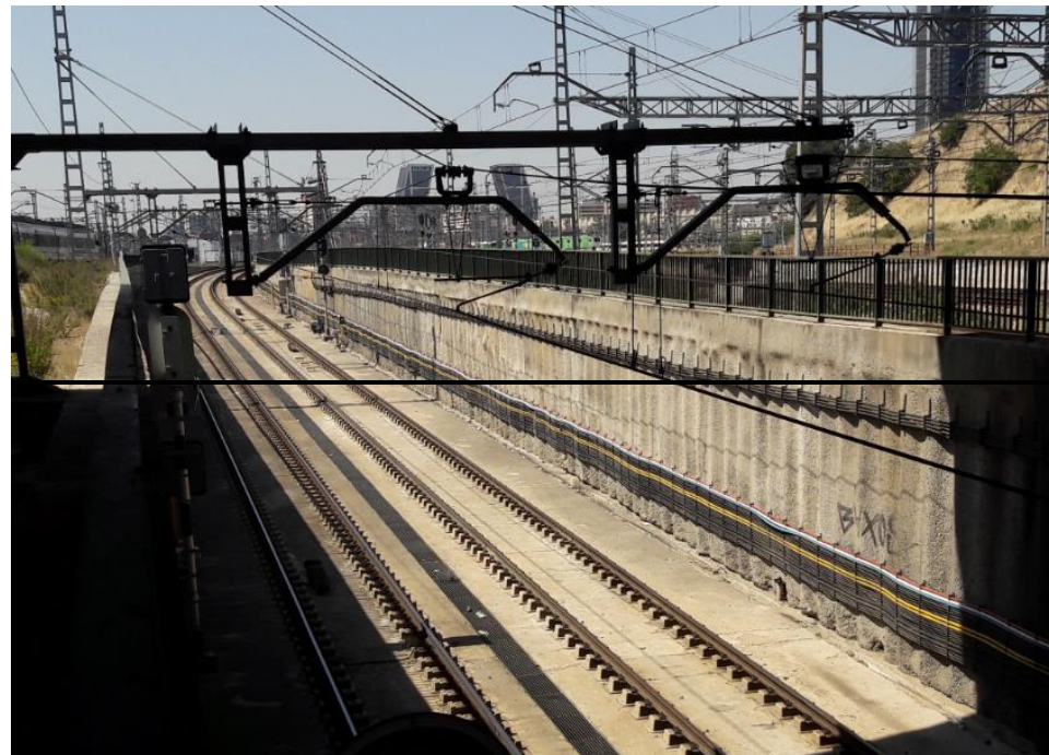
Detalle electrificación salida a ramal Barajas, bajo la M-30
