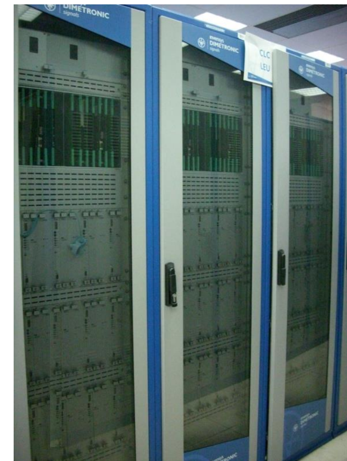
Bastidores de equipamiento ERTMS/ETCS. Chamartín AV
