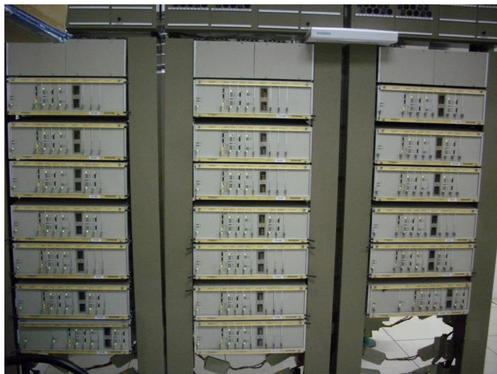
Equipos interiores circuitos de vía de Chamartín AV
