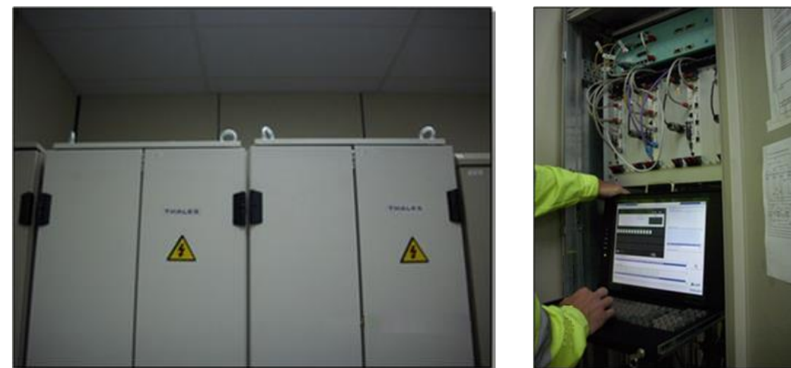
Vista de los armarios CLC y SAM-CLC (equipamiento ERTMS/ETCS)
