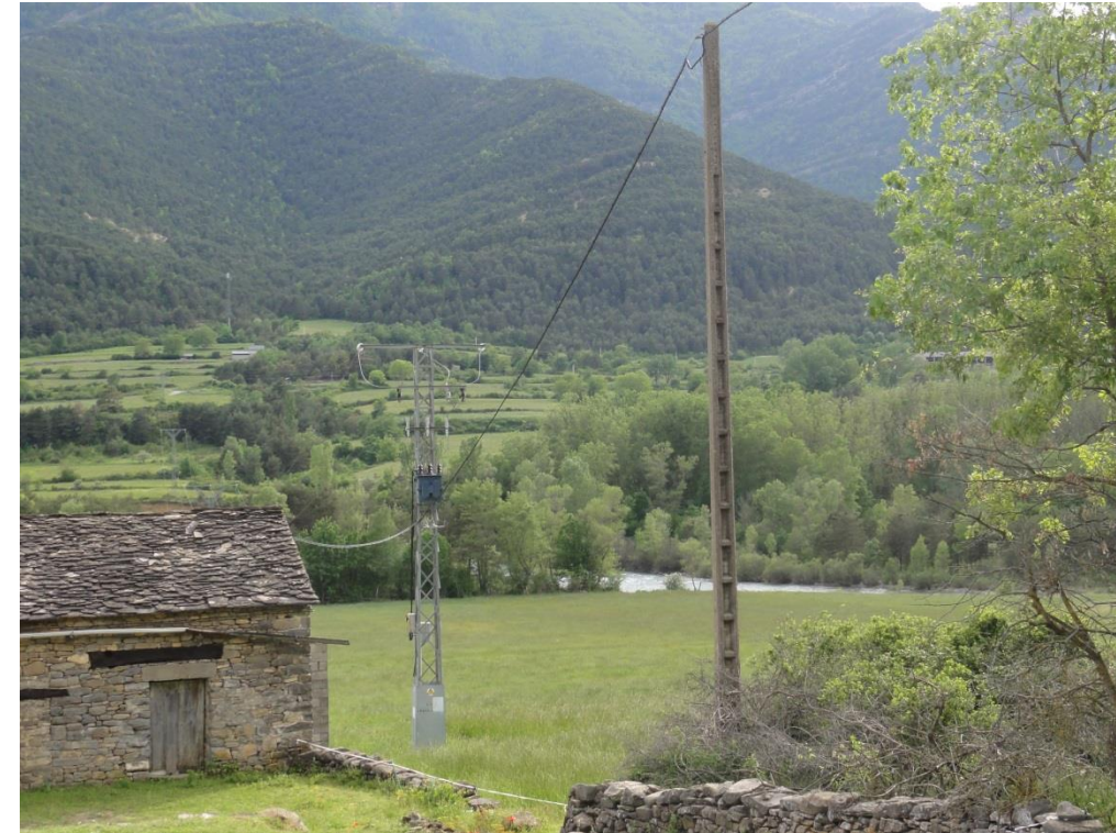
Derivación de línea eléctrica a baja tensión cruzando la carretera en Arresa
