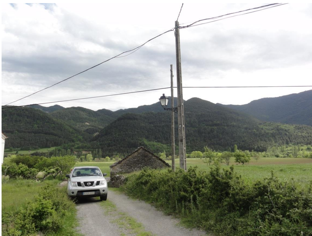
Línea eléctrica de baja tensión y línea de teléfonos aérea
