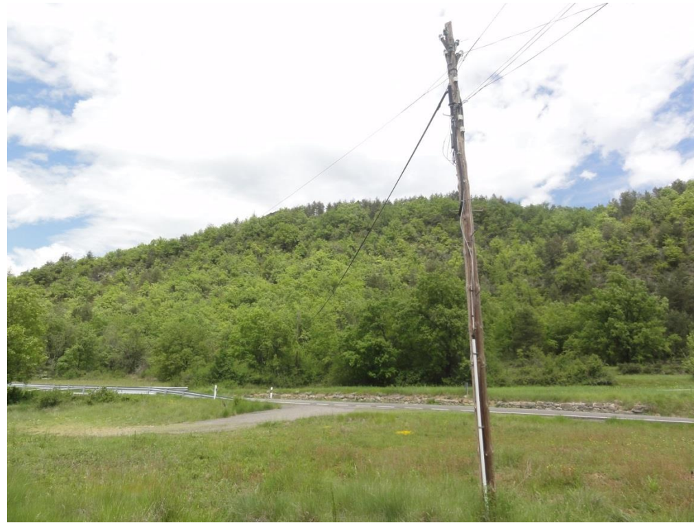
Línea de teléfonos aérea
