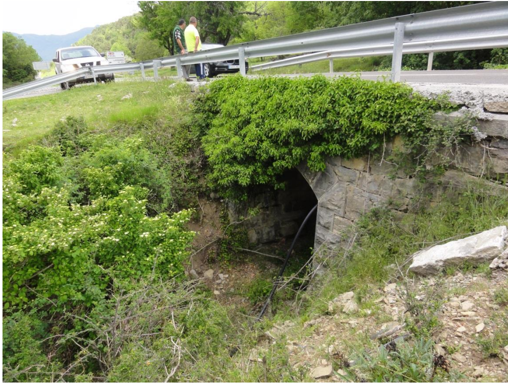
Tubería de abastecimiento descubierta y riego por obra de drenaje
