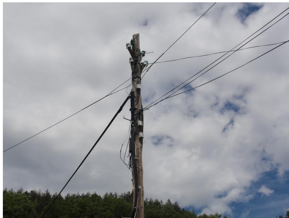
Línea de teléfonos aérea
