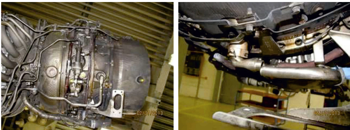
Figura 9. Rotura de la tubería de ventilación del aceite de lubricación de los cojinetes n.º 6 y 7
