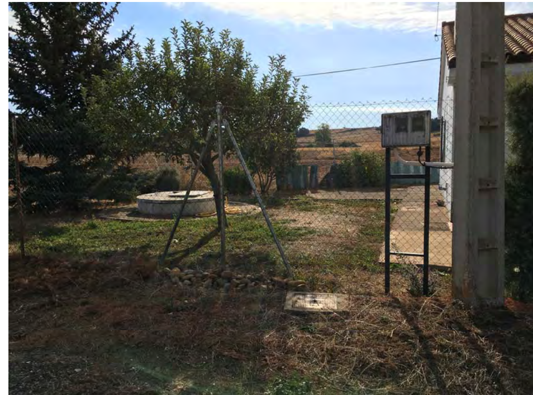
Acometida eléctrica aérea a edificación.
