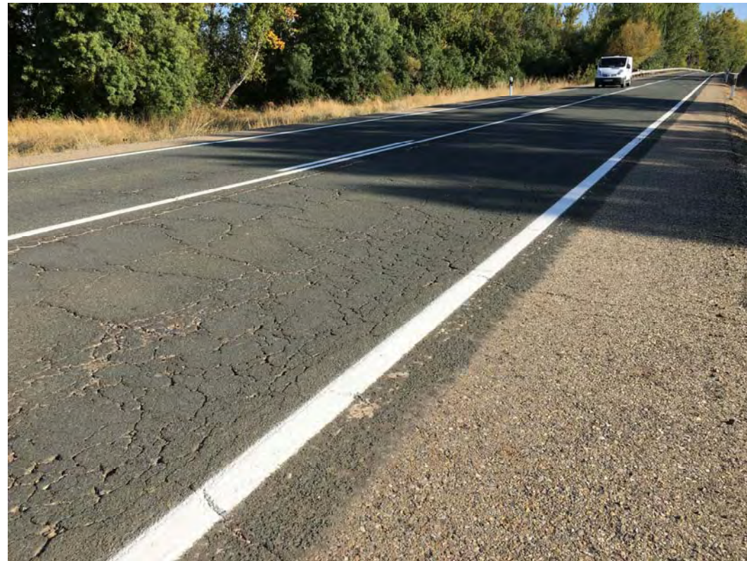
Zona agrietada en calzada
